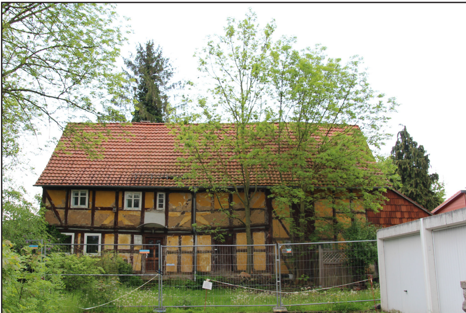
Abb. 39: Dringend sanierungsbedürftiges Gebäude
